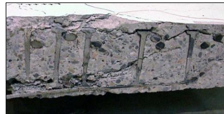
d) Ruptura entre camadas de armadura (IN*) (BIRKLE, 2004)
