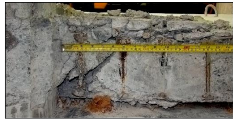
b) Ruptura na região da armadura (IN) (FERREIRA, 2010)
